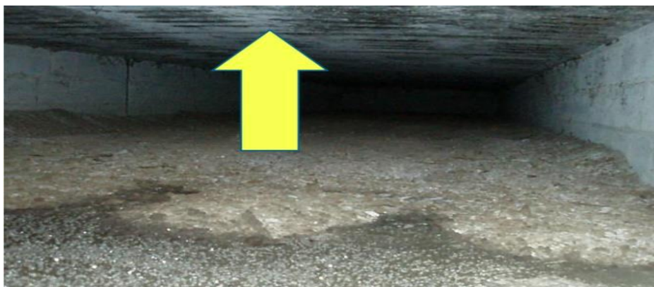
Foto. 4 Kanał wentylacyjny podziemny z osypana ziemią i złogami chloroprofamu (CIPC).
